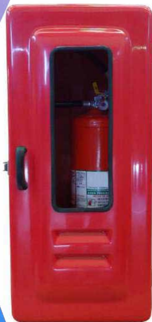
Abrigo de Extintor
